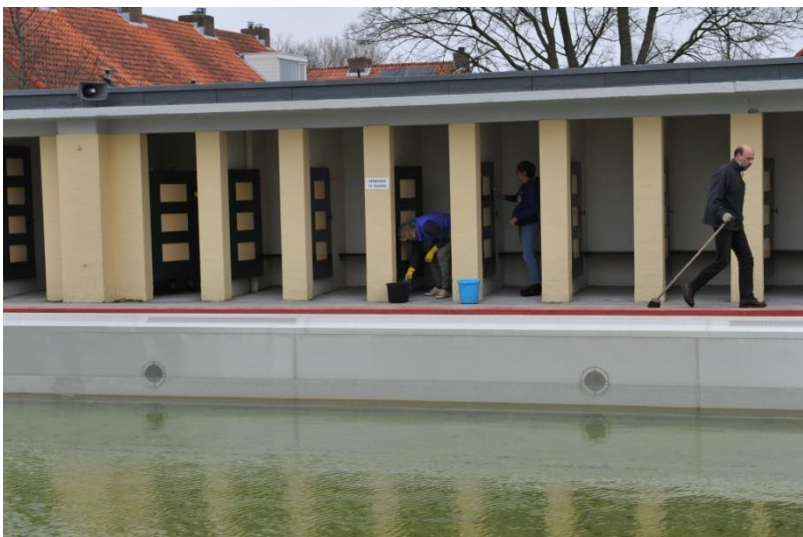
Schoonmaakactie Om het zwembad weer toonbaar te maken.
